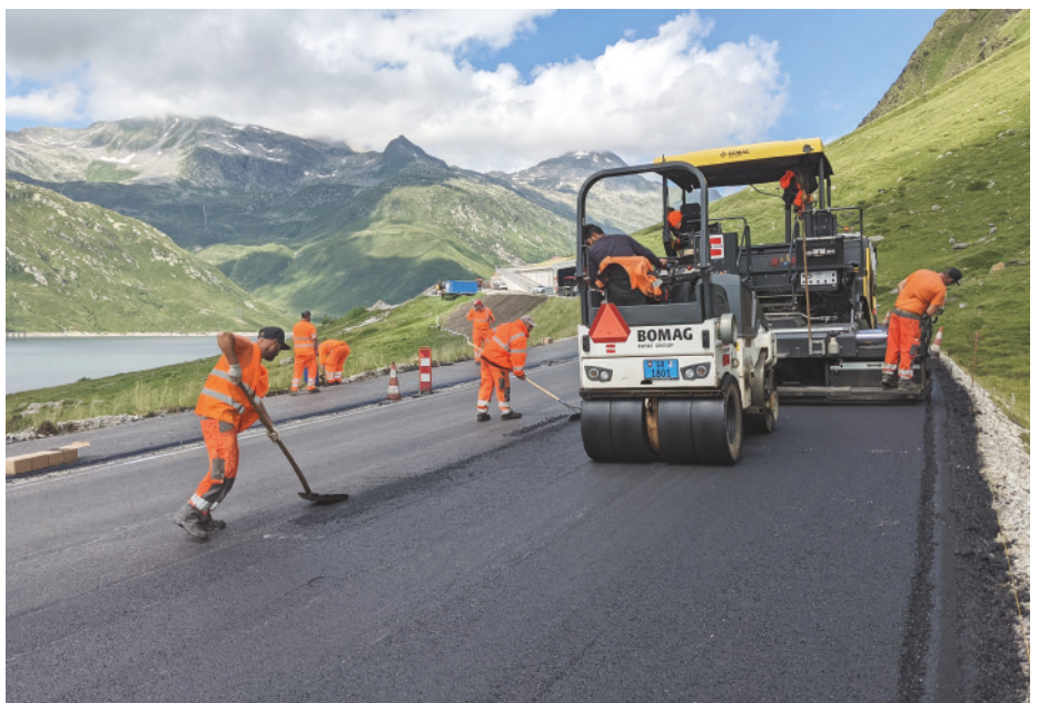
La piste d'essai de l'Empa sur la route du Lukmanier: certaines couches contiennent jusqu'à 85% d'asphalte recyclé.
