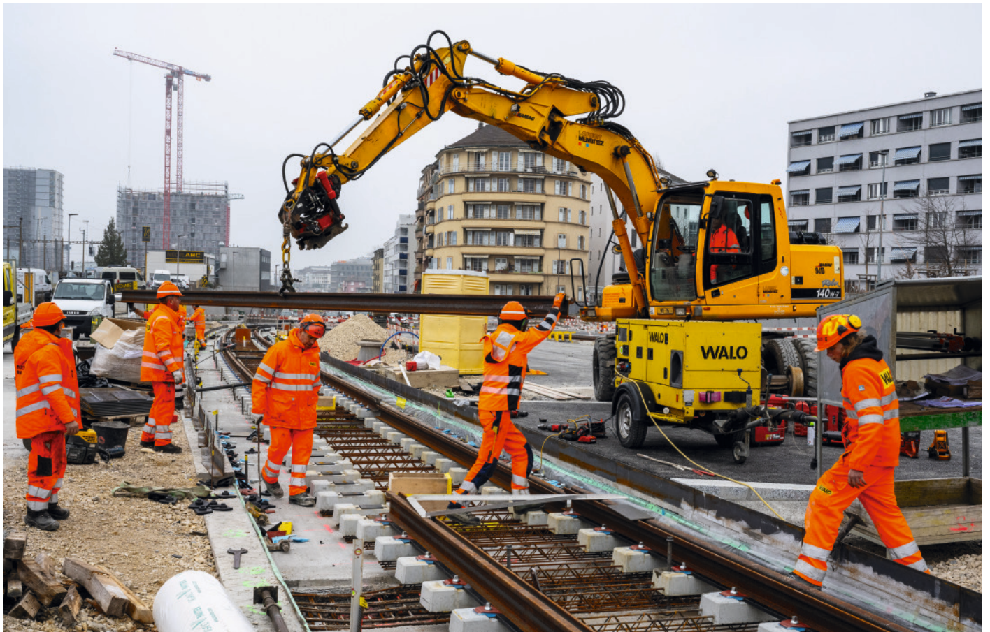
Les rails sont posés sur des dalles flottantes: au total, 50 entreprises participent au projet.
