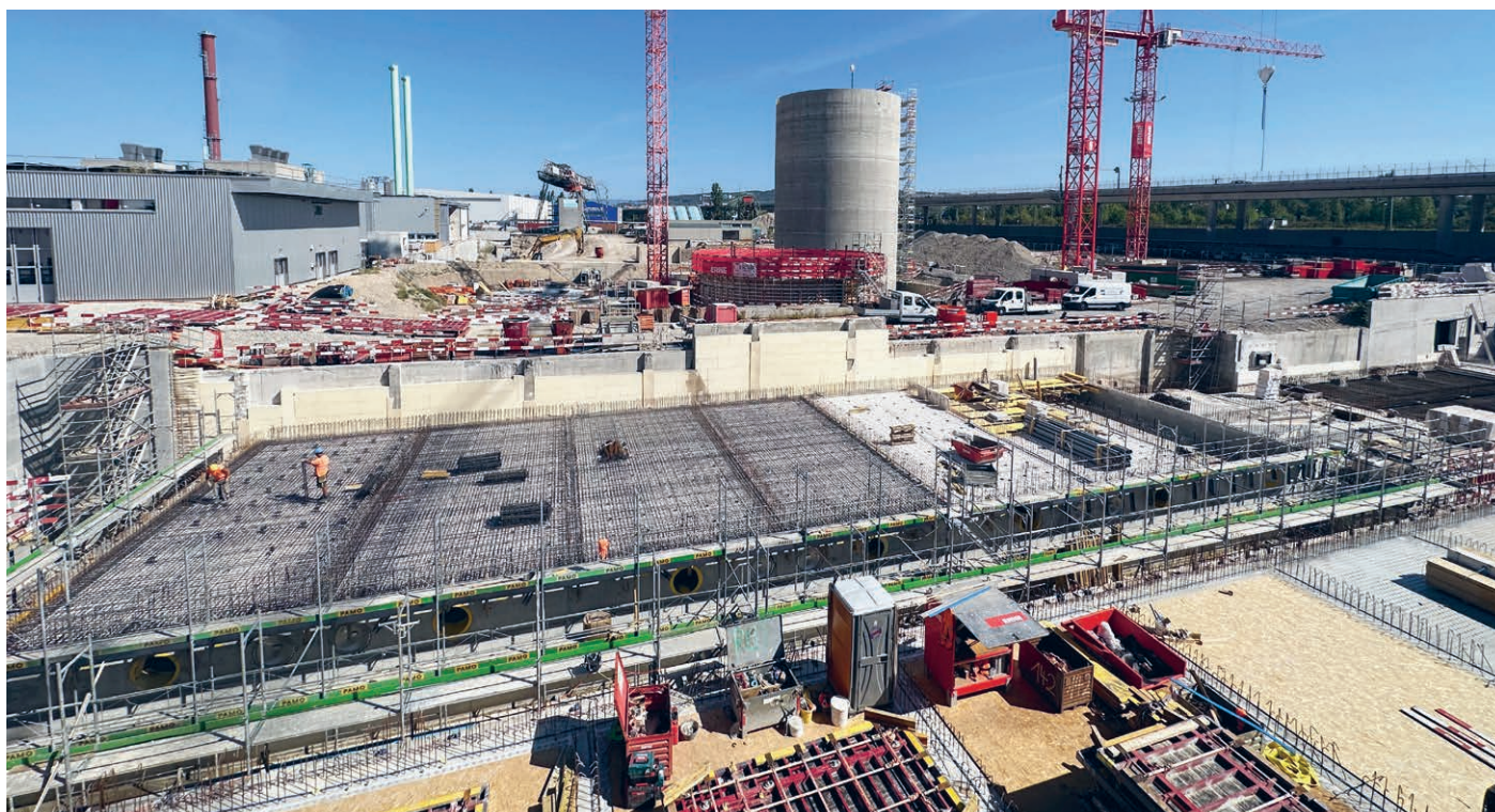
Construction de l'installation de traitement pour l'élimination des micropolluants, derrière la tour de décomposition
