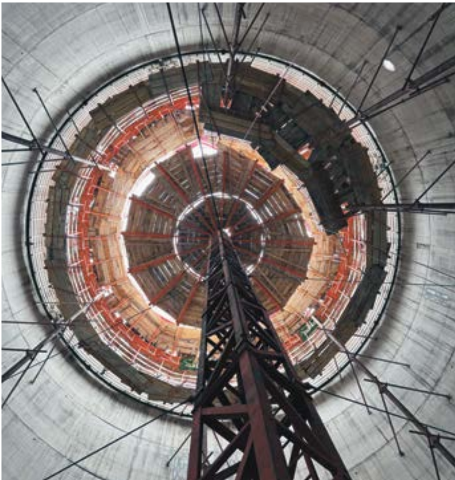
Arbeiten am Faulturm: Chefpolier Waldmeiers Leute betonieren mit Hilfe einer fahrbaren Kletterschalung.
