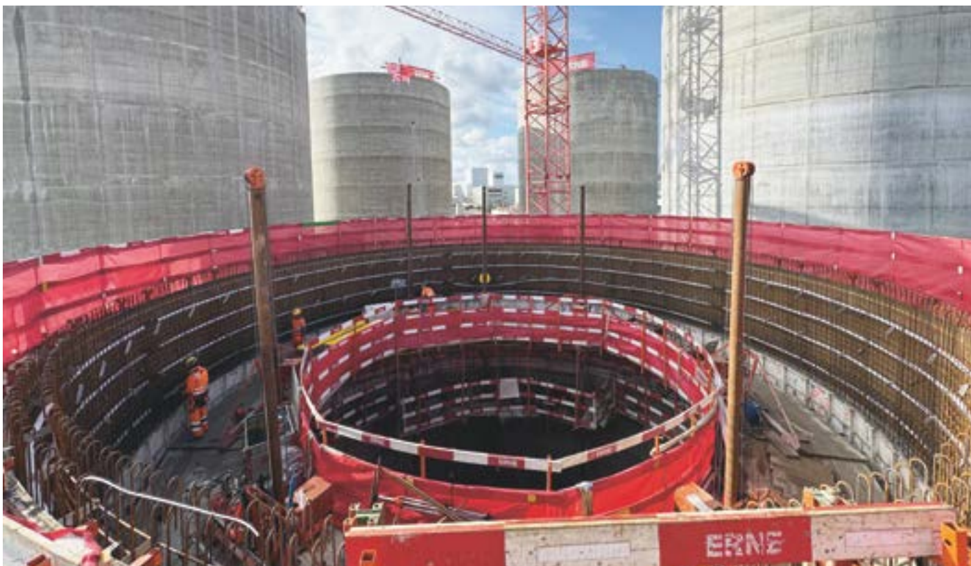
Faultürme für die Biogas-Produktion: um Rissen vorzubeugen, werden zusätzlich zur Armierung Siebenlitz-Kabel gespannt.
