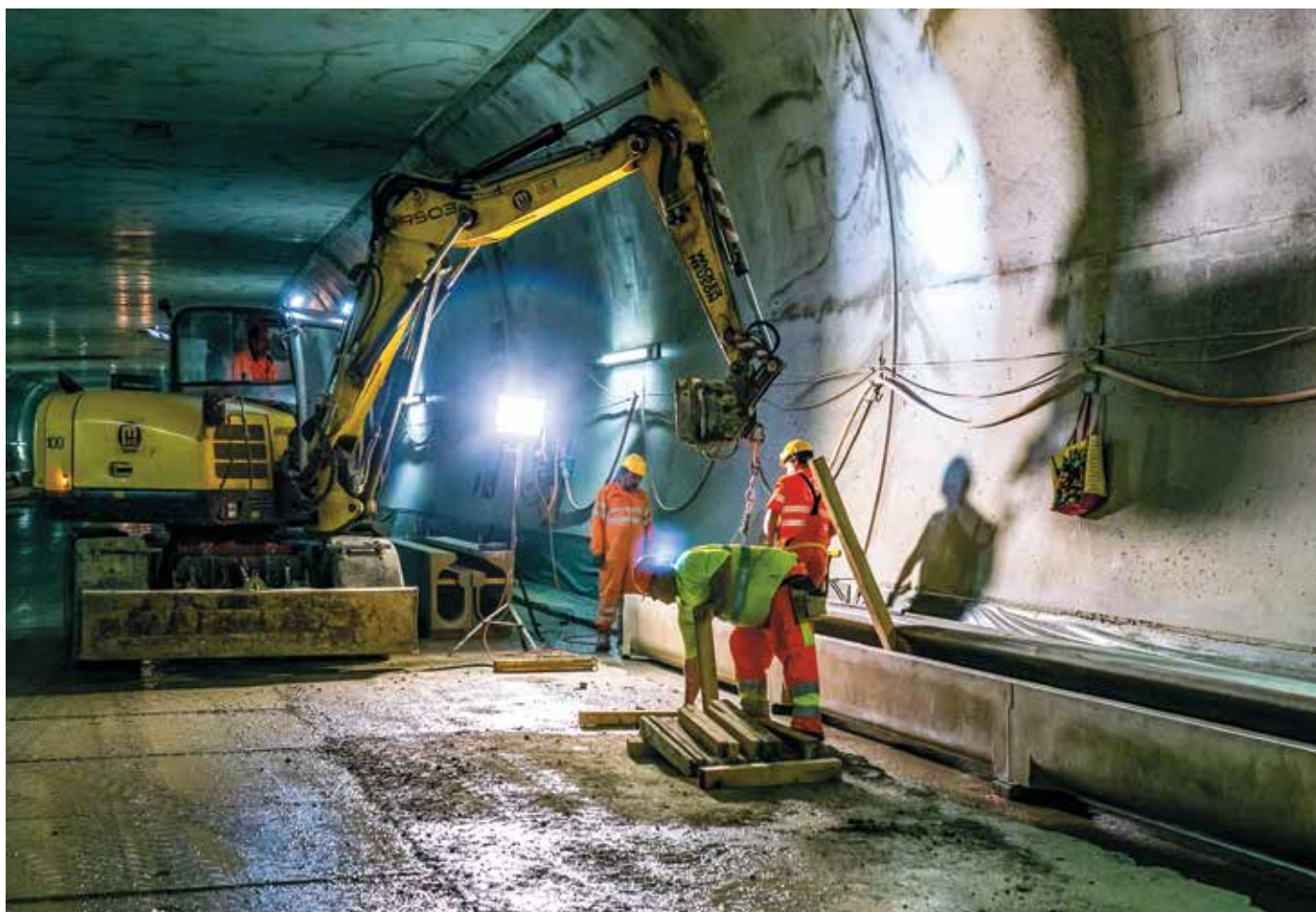
Letzte Ausbaurbeiten, dann übernehmen die BSA-Firmen: Anfang 2023 soll der Verkehr dreispurig durch den neuen Tunnel rollen.
