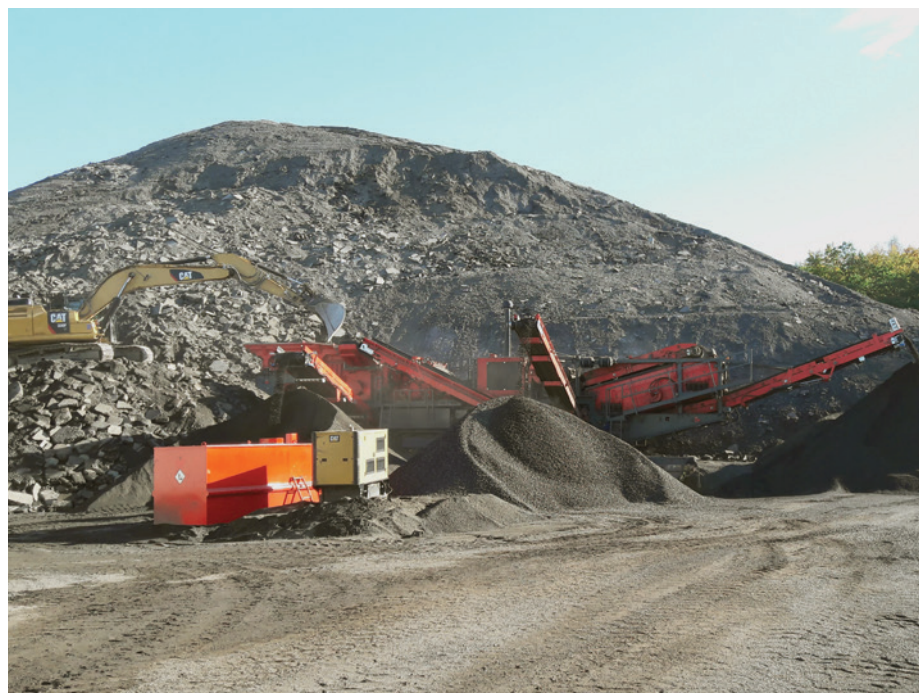
Ressourcenverschleiss: Jedes Jahr landen 750 000 Tonnen Ausbruchasphalt auf Deponien. Foto: Empa
