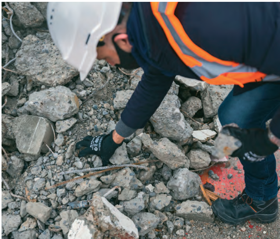
Abbruchschutt wird vor Ort für Recycling-Beton verwendet: In einem ersten Schritt werden die Bruchsteine von anderen Materialien getrennt.
