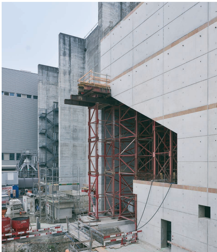
Comme pour la construction d'un pont, des cintres massifs sont utilisés pour ériger les éléments en porte-à-faux d'environ 12m.
