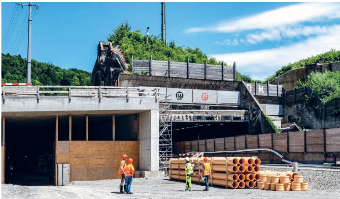
Il a fallu enlever la moitié d'une colline pour faire de la place au troisième tube : portail ouest près de Weiningen.
