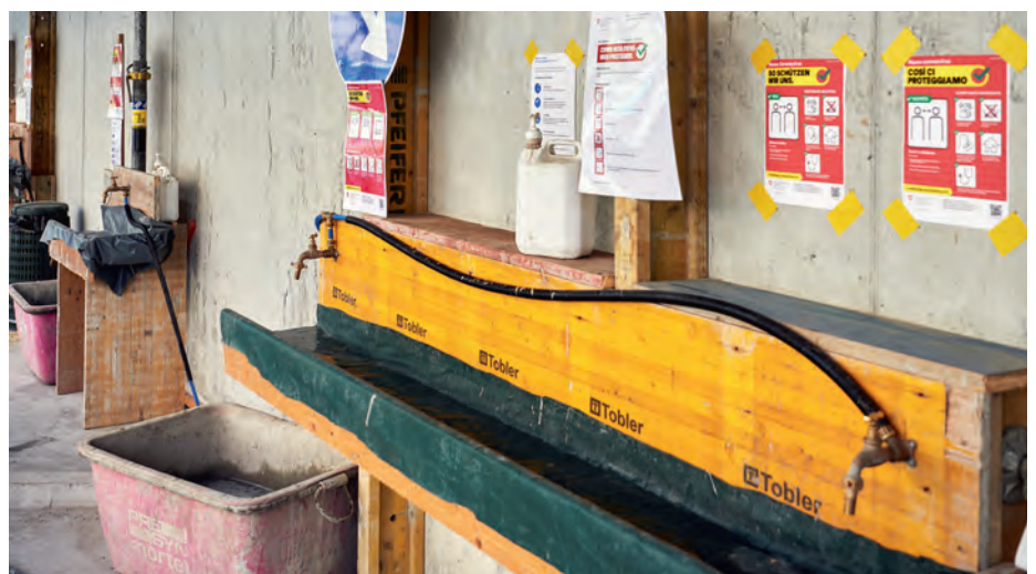
Face aux amendes pour retards et au risque d'une faillite, les entreprises pourraient être tentées de ne plus respecter les normes d'hygiène afin d'accélérer le travail. Photo Manu Friederich.
