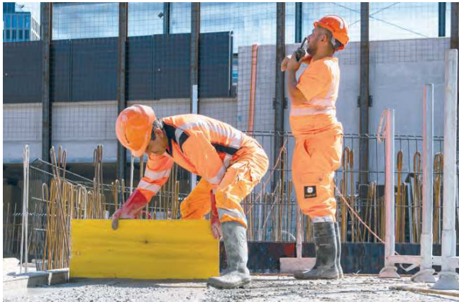
Consignes et répartition des tâches claires: l'organisation est le b.a.-ba d'un chantier plus efficace et plus sûr.
