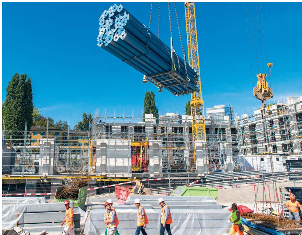
«Le chantier du futur»: A Pont-Rouge, on teste de nouvelles façons d'organiser le travail et on tente d'obtenir un label pour les constructions durables.
