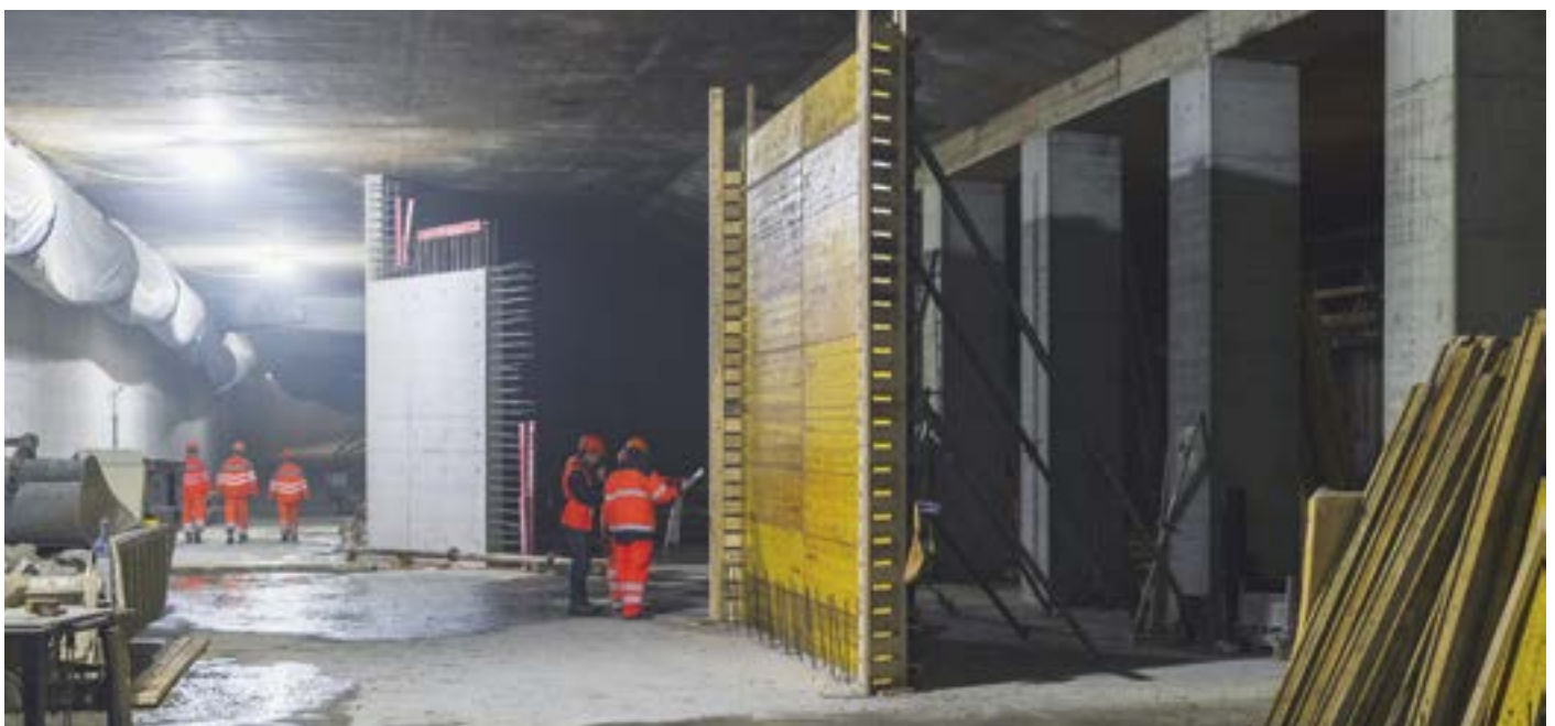
Für Autos gebaut, für Velos genutzt: Betonarbeiten im Stadttunnel unter dem Zürcher HB.
