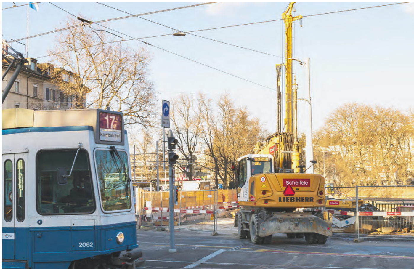
Des espaces exigus : échelonnement rigoureux des travaux pour éviter de bloquer le trafic.
