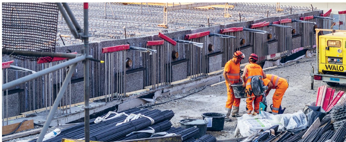
À peine les poutres en bétons installées, elles sont déjà coffrées et on coule le béton.
