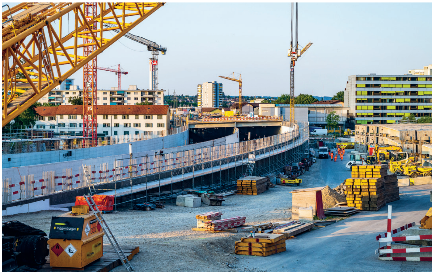
La couverture de l'autoroute: les murs sont finis, il manque encore le toit.
